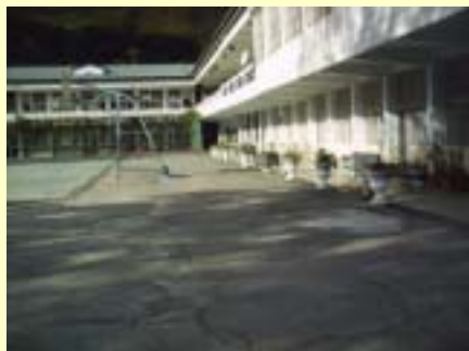
施工前照片-辦公室前既設pc面層打除 鋪設透水磚-日期94.11.1
