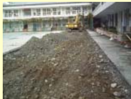
施工中照片-辦公室前既設pc面層打除 做為碎石級配-日期94.12.28
