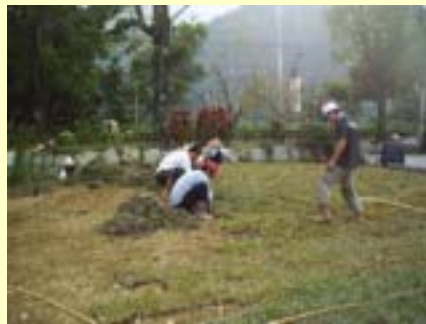
施工中照片-校門右側既設pc面層打除後利用廢土水泥塊堆成土丘種植草皮日期94.1.6
