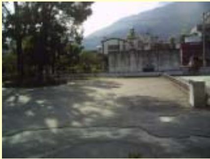
施工前照片-校門右側既設pc面層打除後利用廢土水泥塊堆成土丘種植草皮日期94.11.1
