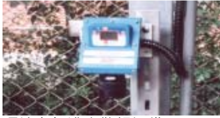
環境臭氧濃度警報設備
