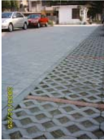
車道採用加厚透水磚,車位採用植草磚,擴大基地保水效益
