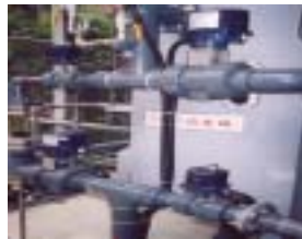
三層砂過濾設備
