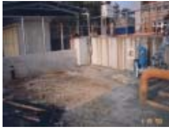
再生水處理設備設置處
