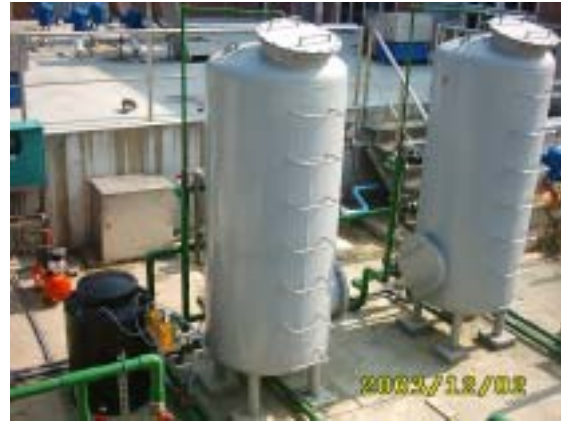
再生水處理設備
