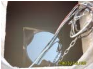
初期雨水截留槽內之較污濁降雨,予以排除可降低雨水處理負荷
