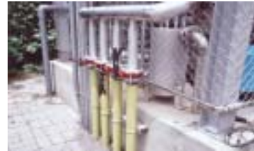
草綠色再生水配水管線
