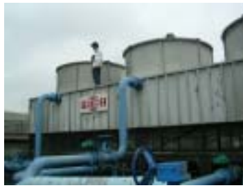
冷卻水塔設備
