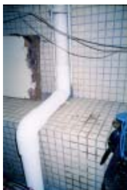
利用既有管路接用雨水
