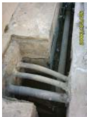
利用建築物既有雨排 水管路分離接續雨水
