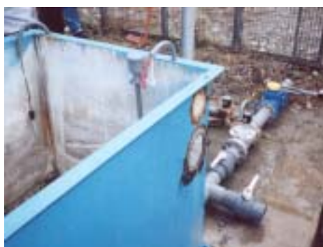
離子交換逆洗水貯水槽
