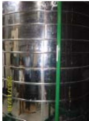
回收水緩衝槽
