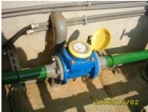
水量計測設施
