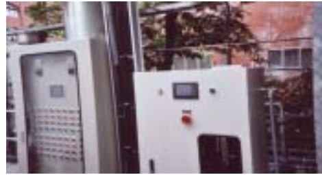
HMI 人工界面及臭氧產生設備
