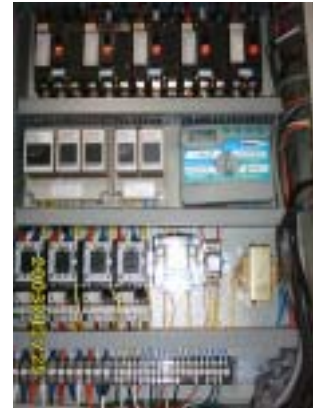
位於岩心館地下室之雨水利用 PLC 控制系統
