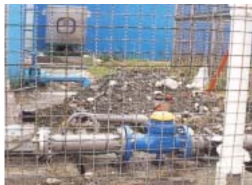
設置回收水流量計量設備
