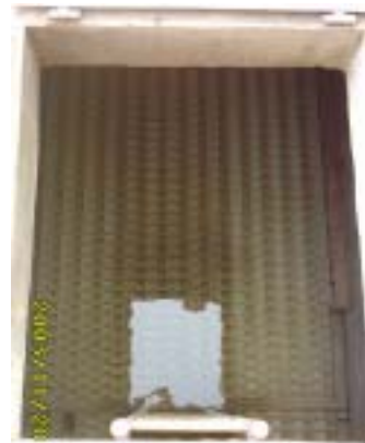
傾斜管設施增加沉澱效率
